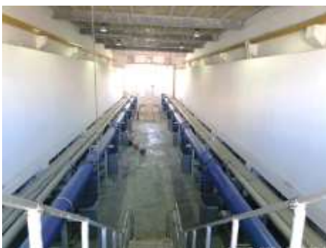
Neue Rohrleitungsanordnung im Ventilraum
